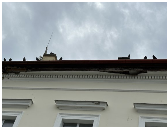
22. kép – lepergett diszvakolat a homlokzaton
