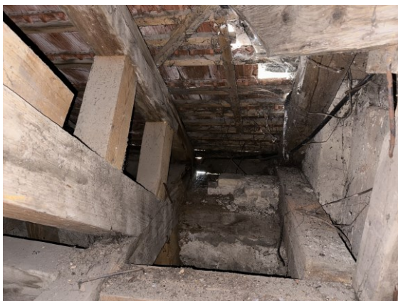
19. kép – hiányos héjalás a vápa alatt a keleti oldalon
