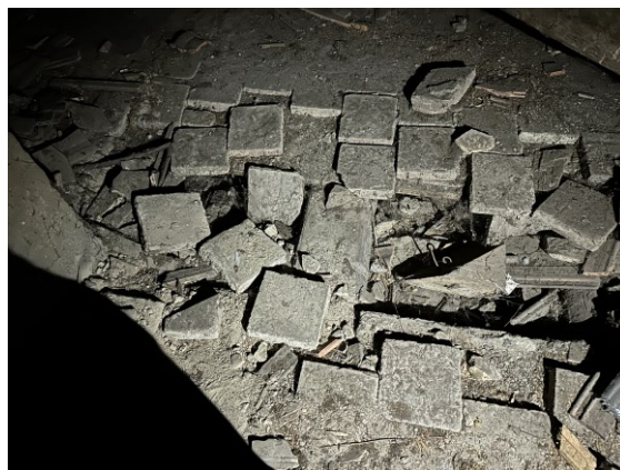
27. kép – beszakadt födémdeszkázat
